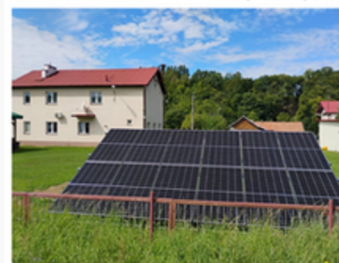
Ochotnicza Straż Pożarna w Wolicy zamontowała panele o mocy 6,3 kWp.
