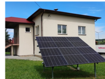
Ochotnicza Straż Pożarna w Nowotańcu zamontowała panele o mocy 2,49 kWp.
