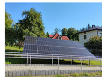
Ochotnicza Straż Pożarna w Pobiednie zamontowała panele o mocy 6,3 kWp.
