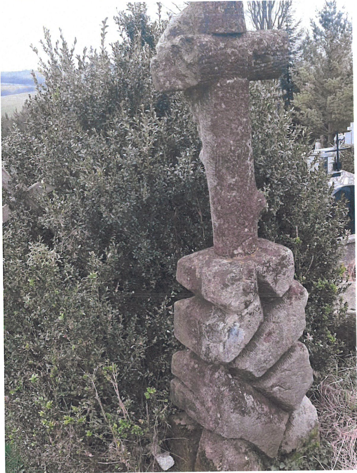
Fot. nr 2. Kamienne nagrobki z cmentarza parafialnego w Nowotańcu. Widoczne na fotografii: silne zabrudzenia powierzchni kamienia, nawarstwienia mikrobiologiczne, pogrążona podwalina. Fot. Janusz Leń marzec 2024 r
