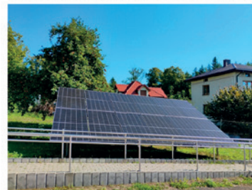
Ochotnicza Straż Pożarna w Pobiedzianach zamontowała panele o mocy 6,3 kWp.
