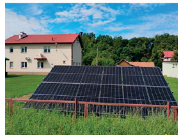
Ochotnicza Straż Pożarna w Wołczy zamontowała panele o mocy 6,3 kWp.
