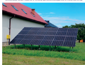
Ochotnicza Straż Pożarna w Tokarni zamontowała panele o mocy 6,3 kWp.
